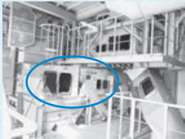
焼損したアルミ選別機
