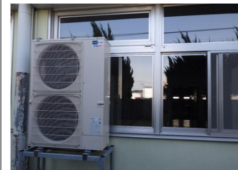
② 1階仮眠室 室外機
