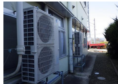
① 1階待機室 室外機
