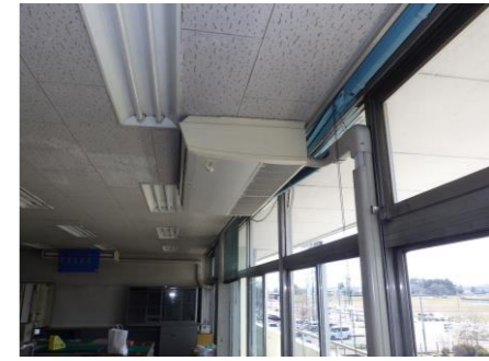
④ 署執務室 室内機
