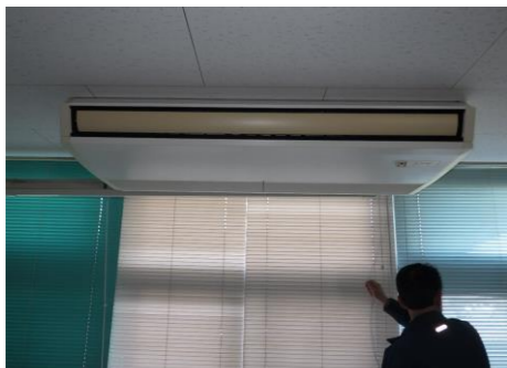
① 1階 待機室 室内機
