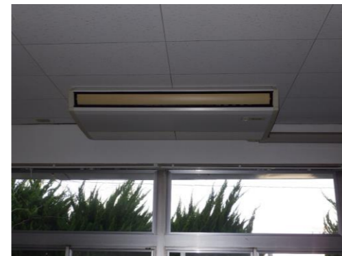
② 1階仮眠室 室内機
